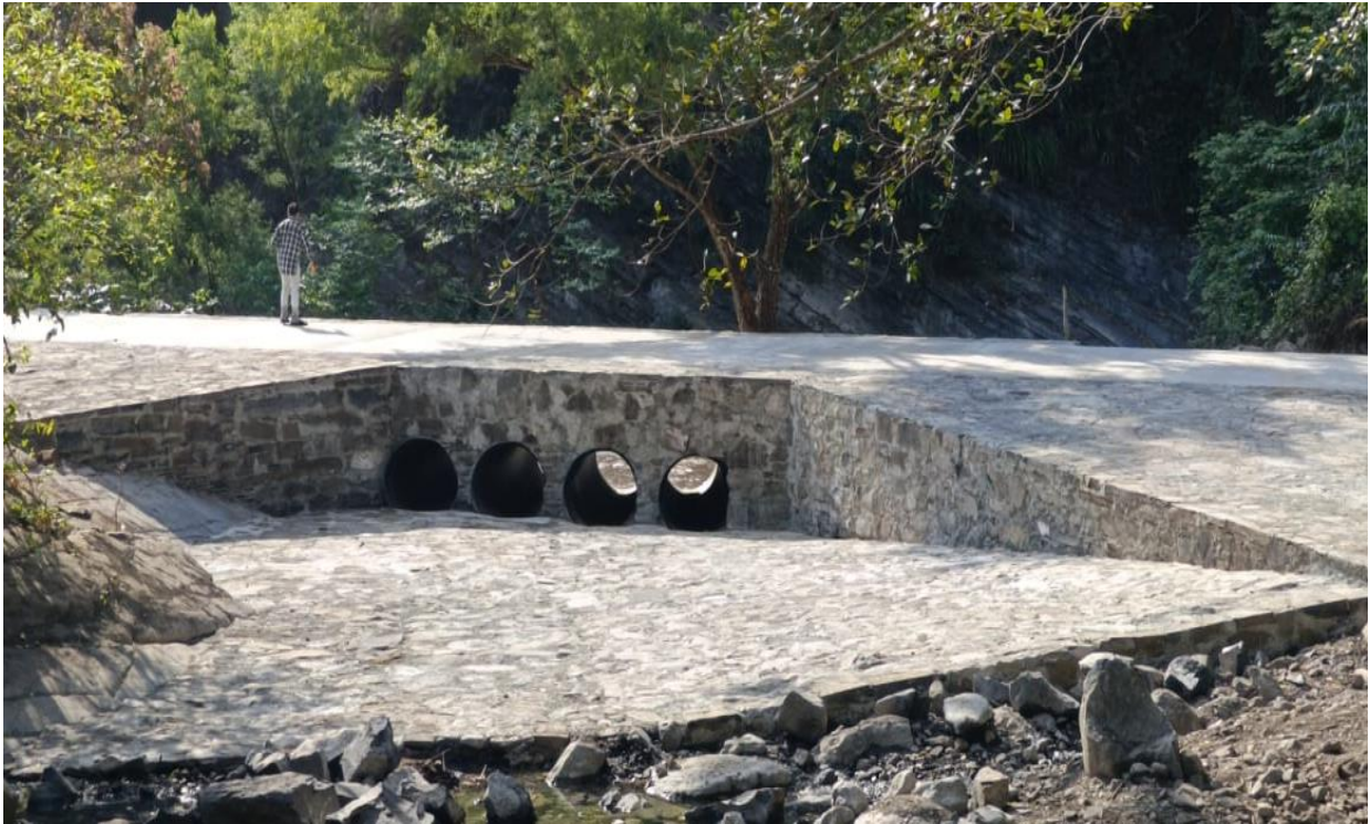
Imagen 69. Construcción de rampa de concreto y alcantarilla vado en acceso a Santiaguito.
